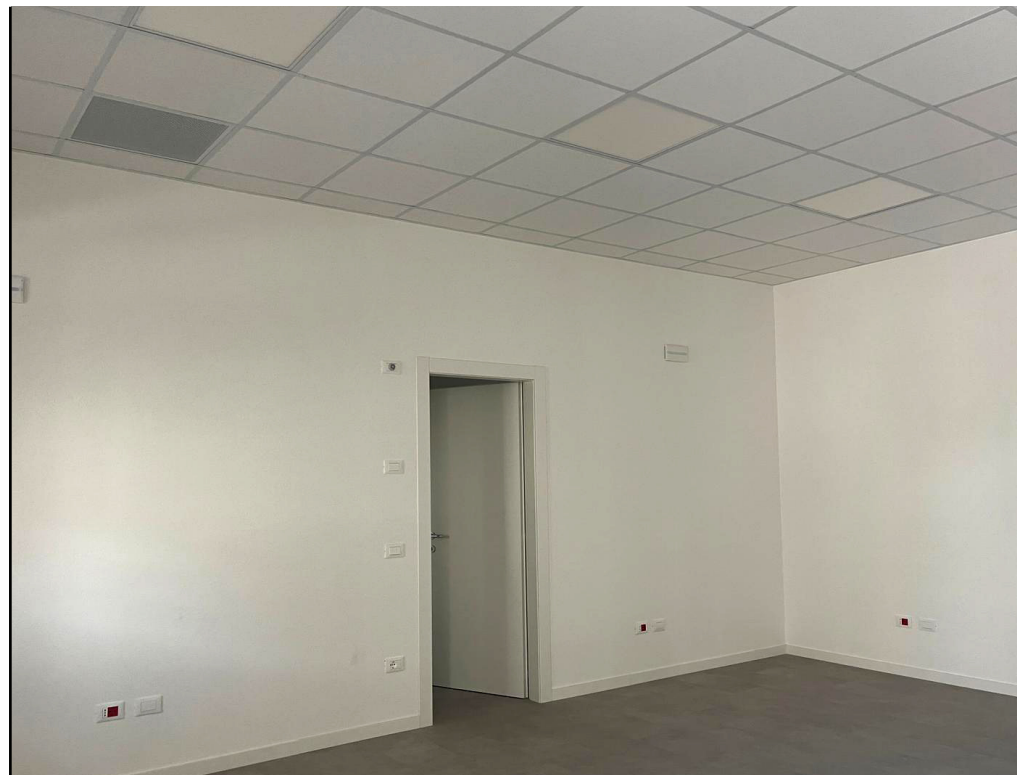
Lavori completati dal Comune per la nuova sede delle Poste di Casoni di Mussolente.
